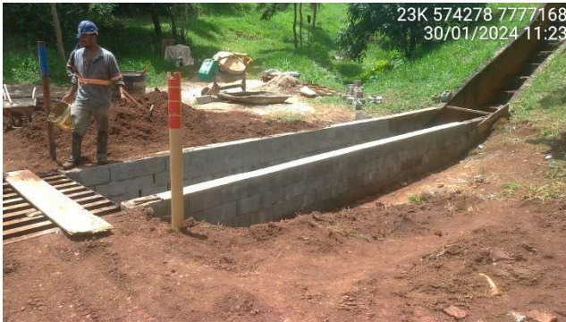
Foto 5.9 – Adequação da parede do canal e implantação de grade para passagem de veículos.
