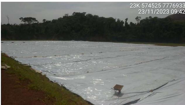
Foto 5.1 – Reservatório da barragem parcialmente impermeabilizado.
