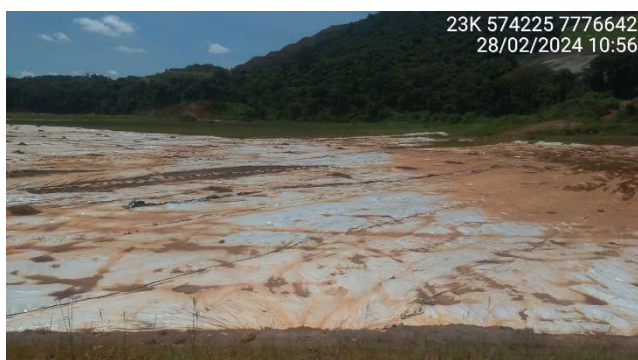
Foto 5.1 – Reservatório parcialmente impermeabilizado.
