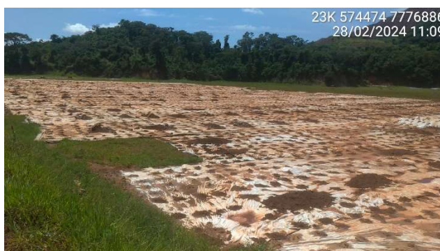
Foto 5.2 – Reservatório parcialmente impermeabilizado.
