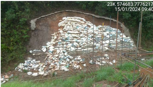
Foto 5.5 – Estrutura de contenção colapsada.
