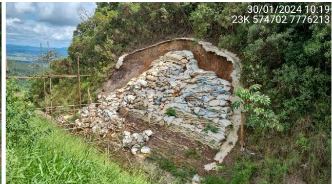
Foto 5.6 – Estrutura de contenção colapsada.
