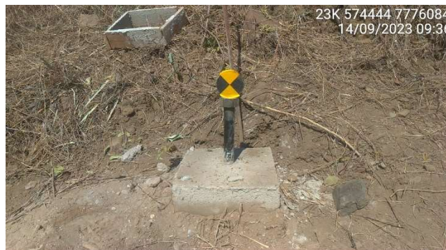
Figura 5.10 – Marco de controle na margem esquerda do reservatório.
