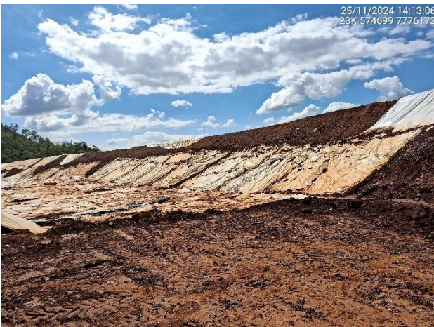
Foto 6.41 – Falha no revestimento do reservatório e talude de montante.
