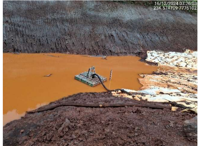
Foto 6.28 – Acúmulo de água no sump do reservatório.
