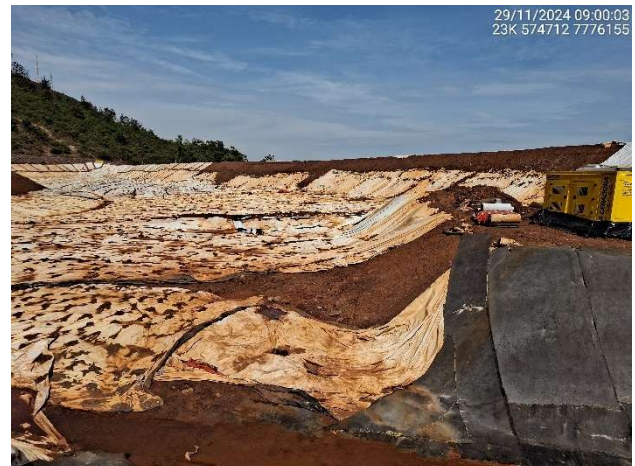
Foto 6.42 – Falha no revestimento do reservatório e talude de montante.
