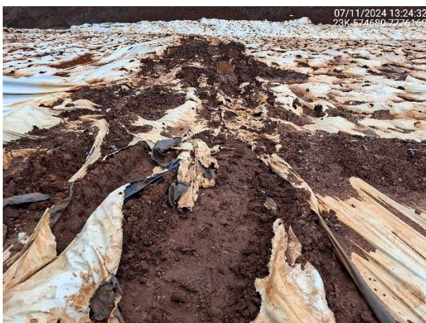
Foto 6.19 – Revestimento do reservatório danificado devido ao tráfego de equipamentos.
