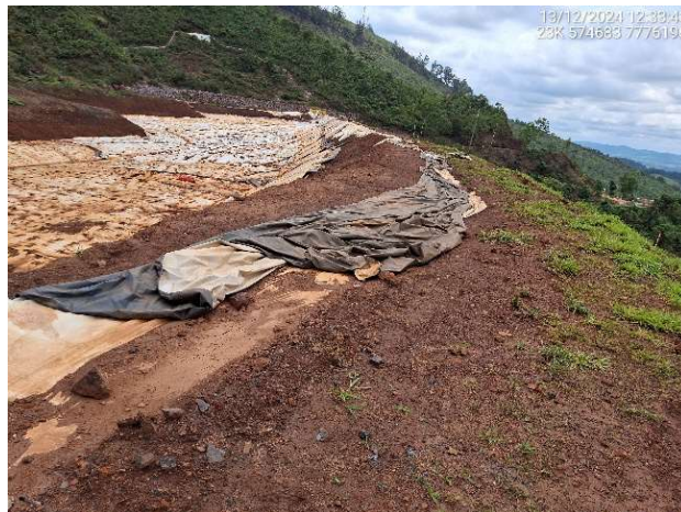
Foto 6.34 – Instalação inadequada do PEBD na crista e na face do talude de montante.
