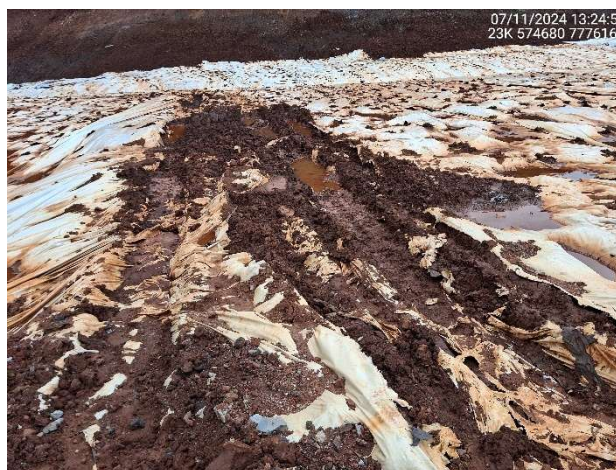
Foto 6.20 – Revestimento do reservatório danificado devido ao tráfego de equipamentos.
