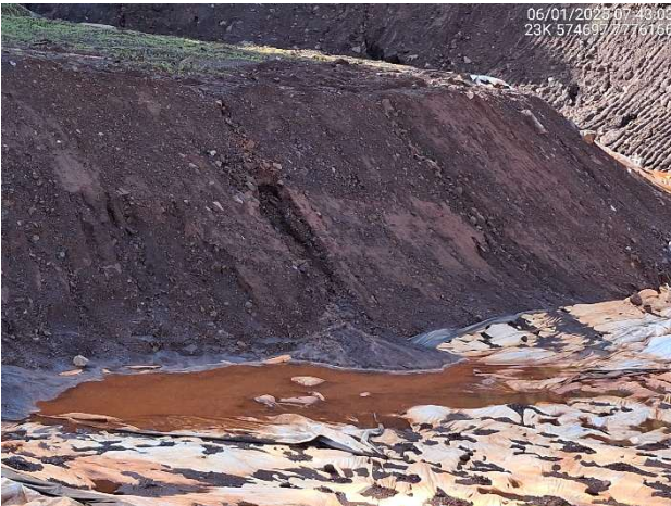
Foto 6.65 – Erosão na face do talude de montante.
