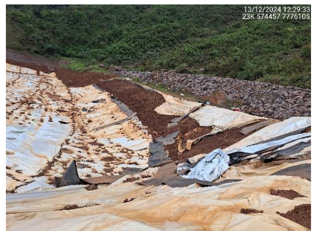
Foto 6.44 – Falha no revestimento do reservatório e talude de montante.
