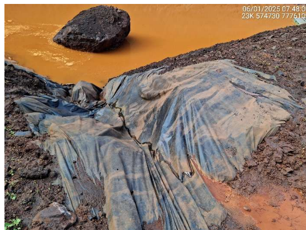
Foto 6.58 – Proteção na região em que foi verificada erosão na face do talude do sump .
