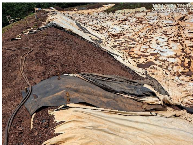
Foto 6.50 – Falha no revestimento do talude de montante.
