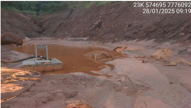
Foto 6.71 – Bomba instalada no sump do reservatório.
