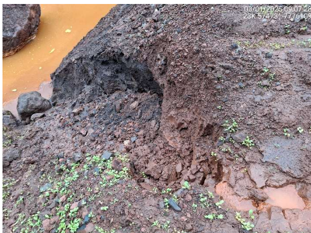
Foto 6.57 – Erosão na face do talude do sump .
