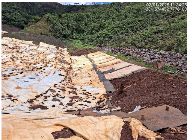
Foto 6.47 – Falha no revestimento do reservatório e talude de montante.
