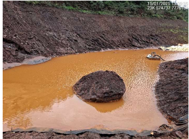
Foto 6.30 – Acúmulo de água no sump do reservatório.
