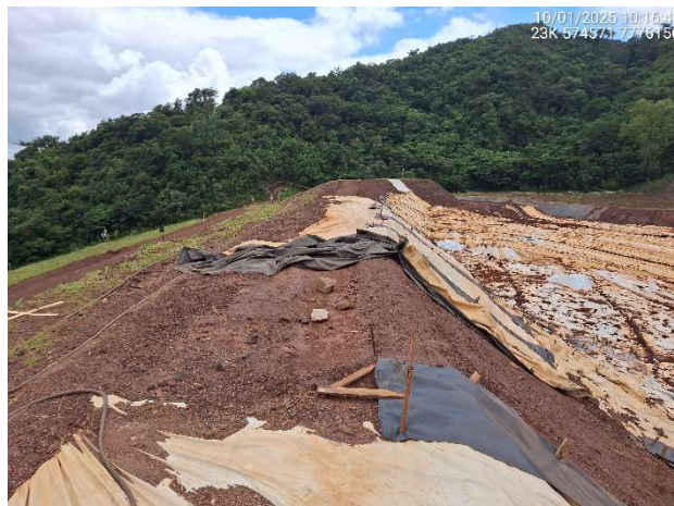
Foto 6.36 – Instalação inadequada do PEBD na crista e na face do talude de montante.
