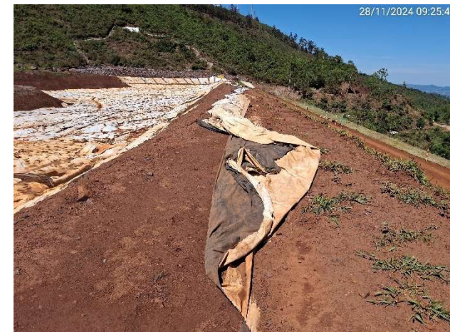
Foto 6.32 – Ancoragem inadequada do PEBD na crista e na face do talude de montante.
