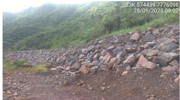
Foto 5.2 – Berma de equilíbrio em enrocamento na encosta próxima a ombreira esquerda.
