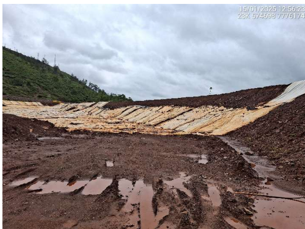
Foto 6.49 – Falha no revestimento do reservatório e talude de montante.
