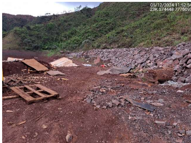
Foto 6.52 – Presença de entulhos na crista e entorno da Barragem B2 - Mina Tico-Tico.
