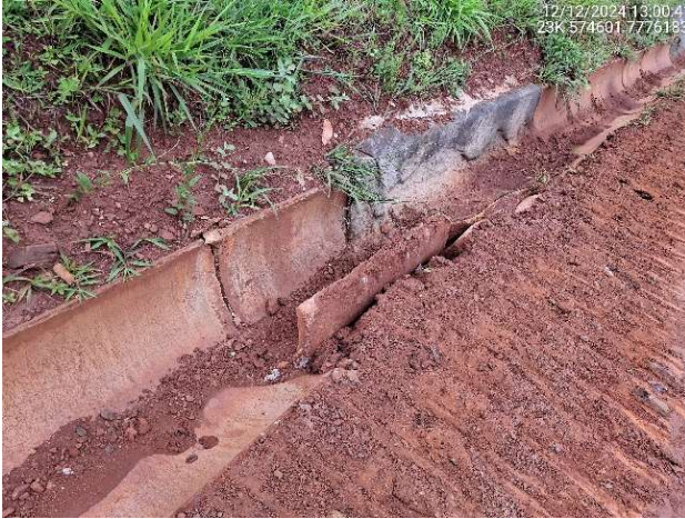
Foto 6.63 – Dispositivo de drenagem superficial da berma 1.119,0 danificado.
