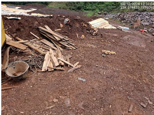
Foto 6.51 – Presença de entulhos na crista e entorno da Barragem B2 - Mina Tico-Tico.
