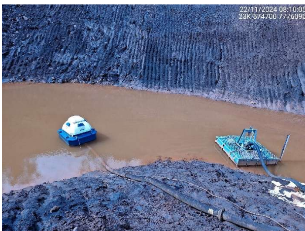
Foto 6.26 – Acúmulo de água no sump do reservatório. Necessidade de instalação de dispositivo de acionamento automático da bomba.
