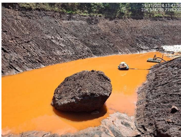
Foto 6.25 – Acúmulo de água no sump do reservatório. Necessidade de instalação de dispositivo de acionamento automático da bomba.
