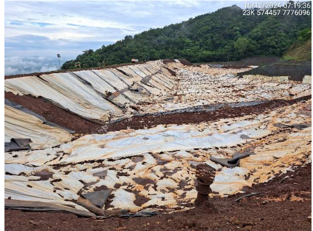
Foto 6.40 – Transpasse inadequado do revestimento do reservatório.
