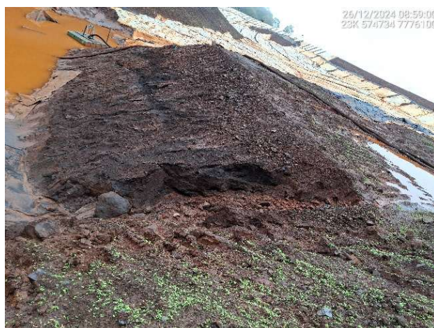
Foto 6.56 – Erosão na face do talude do sump.
