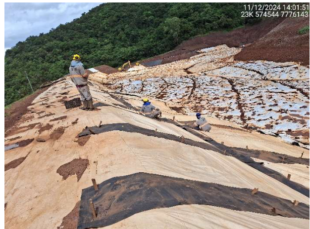
Foto 6.14 – Execução de reparo no revestimento de lona PEBD na face do talude de montante.
