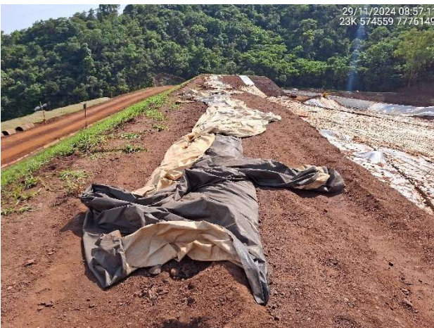
Foto 6.31 – Ancoragem inadequada do PEBD na crista e na face do talude de montante.
