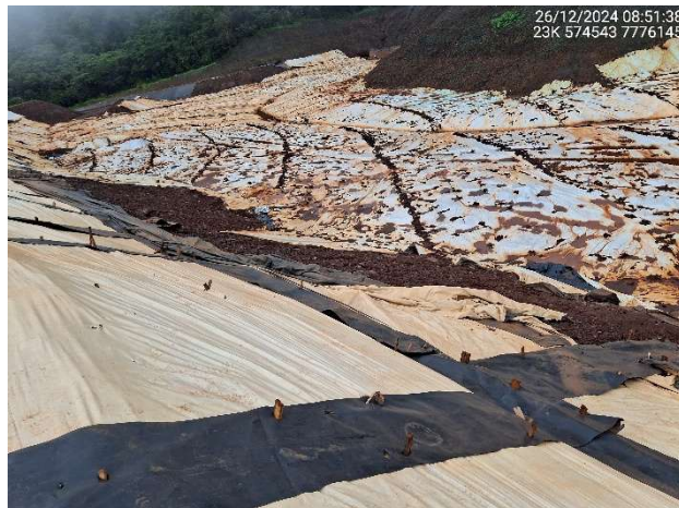
Foto 6.46 – Falha no revestimento do reservatório e talude de montante.
