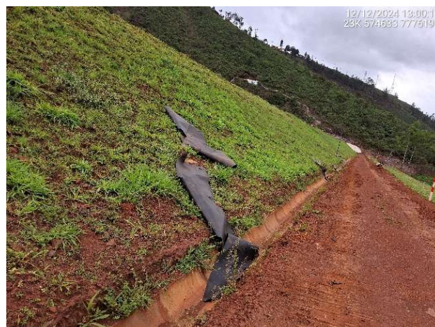
Foto 6.60 – Presença de material solto (geomembrana) na face do talude de jusante.
