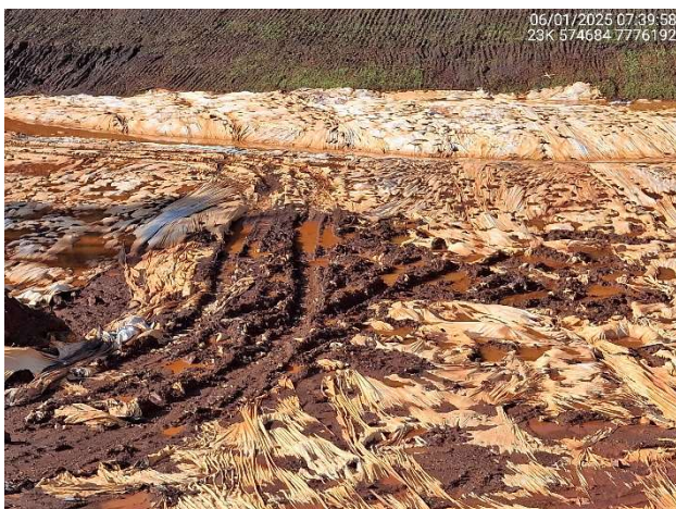
Foto 6.23 – Revestimento do reservatório danificado devido ao tráfego de equipamentos.
