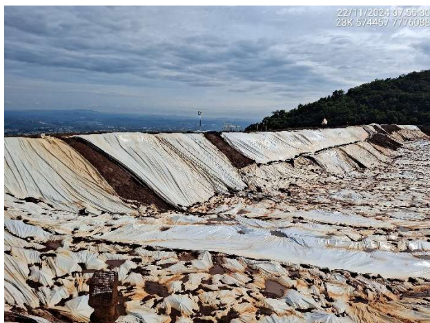
Foto 6.37 – Transpasse inadequado do revestimento do reservatório.
