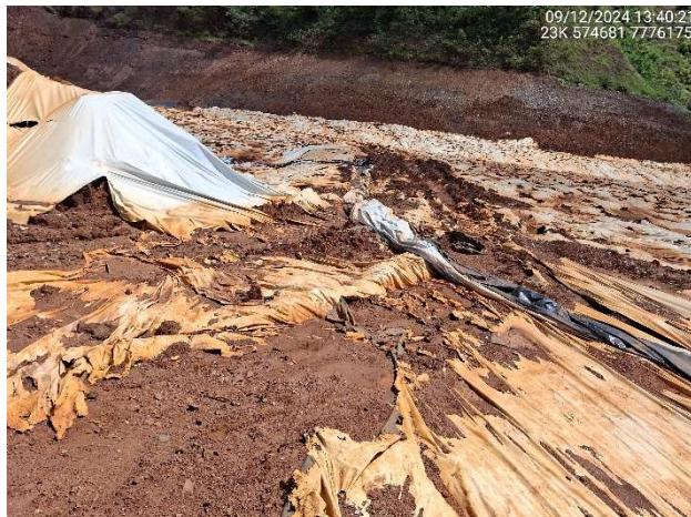
Foto 6.22 – Revestimento do reservatório danificado devido ao tráfego de equipamentos.
