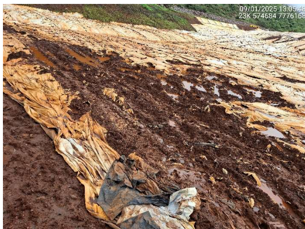
Foto 6.24 – Revestimento do reservatório danificado devido ao tráfego de equipamentos.
