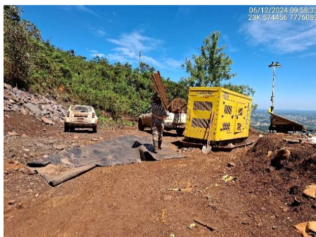
Foto 6.54 – Remoção de entulhos na crista e entorno da Barragem B2 - Mina Tico-Tico.
