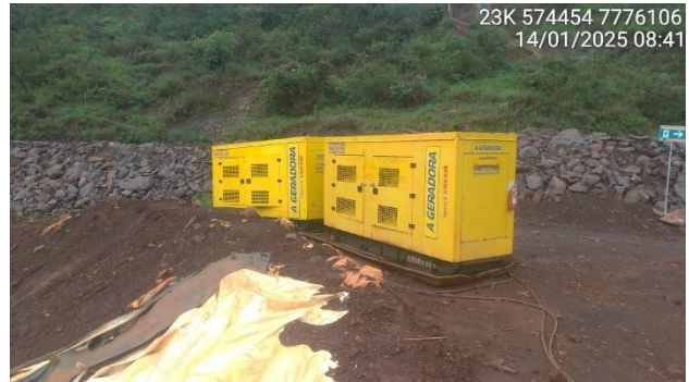
Foto 6.72 – Geradores de alimentação do sistema de bombeamento do sump .
