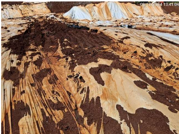
Foto 6.21 – Revestimento do reservatório danificado devido ao tráfego de equipamentos.
