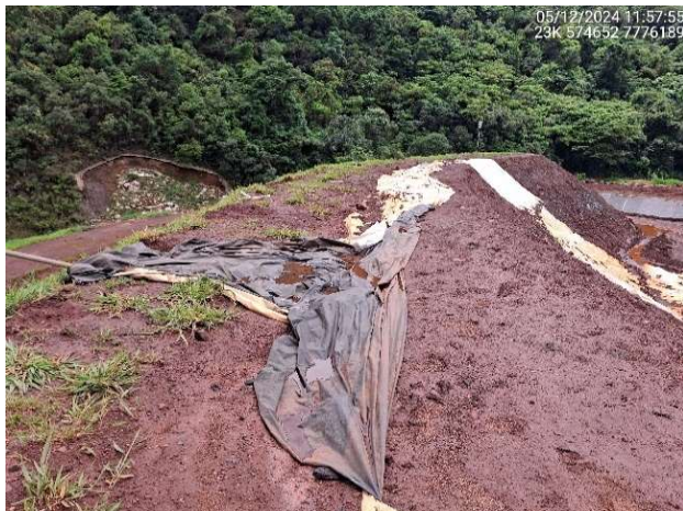
Foto 6.33 – Instalação inadequada do PEBD na crista e na face do talude de montante.
