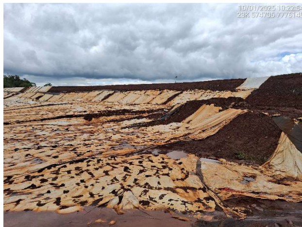
Foto 6.48 – Falha no revestimento do reservatório e talude de montante.
