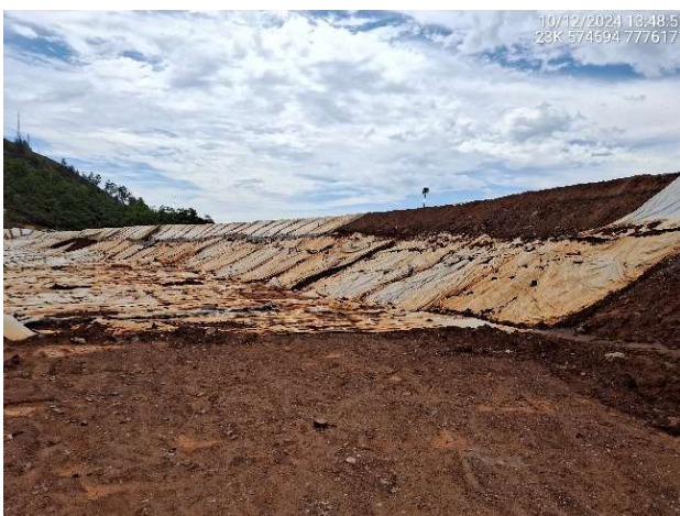
Foto 6.43 – Falha no revestimento do reservatório e talude de montante.
