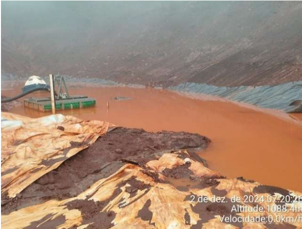
Foto 6.27 – Acúmulo de água no sump do reservatório.
