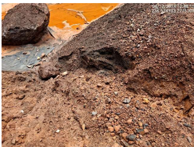
Foto 6.55 – Erosão na face do talude do sump.
