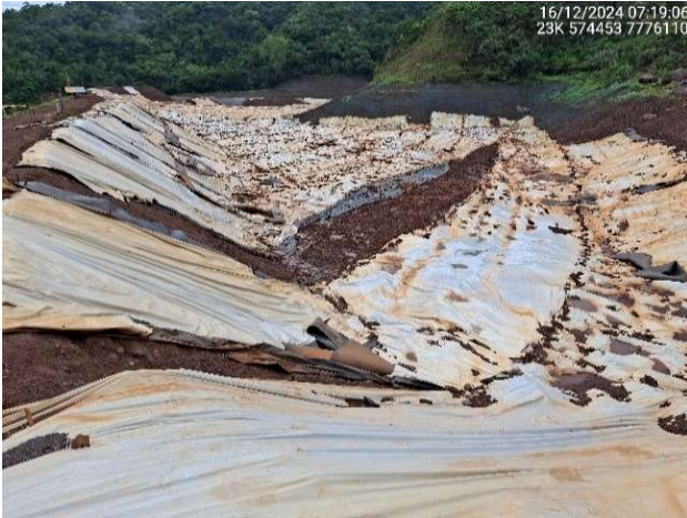
Foto 6.39 – Transpasse inadequado do revestimento do reservatório.
