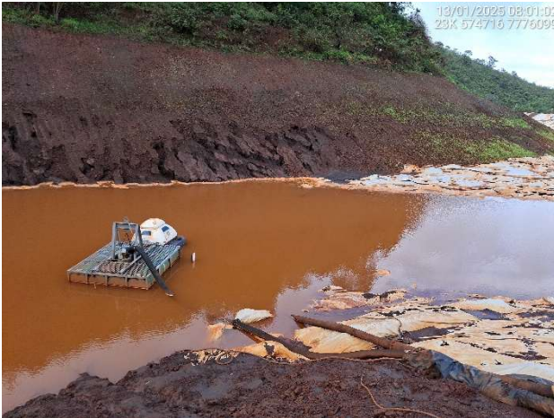
Foto 6.29 – Acúmulo de água no sump do reservatório.
