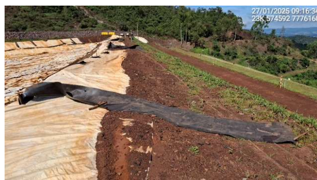
Foto 6.62 – Presença de material solto (geomembrana) na face do talude de jusante.
