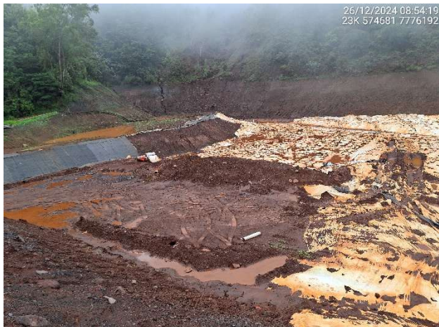
Foto 6.45 – Falha no revestimento do reservatório e talude de montante.
