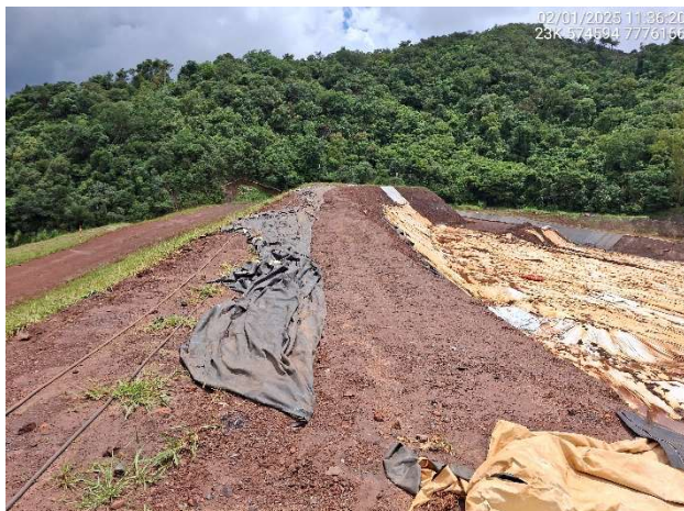
Foto 6.35 – Instalação inadequada do PEBD na crista e na face do talude de montante.
