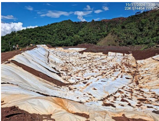
Foto 6.38 – Transpasse inadequado do revestimento do reservatório.
