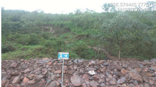
Foto 5.3 –Dispositivos de drenagem superficial no contato da cunha com o terreno natural, na ombreira esquerda.
