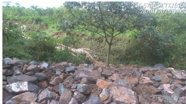
Foto 5.4 –Dispositivos de drenagem superficial no contato da cunha com o terreno natural, na ombreira esquerda.
