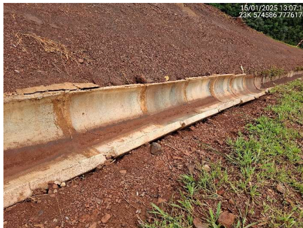
Foto 6.70 – Dispositivo de drenagem superficial da berma elev. 1.119,0 descalçado.
