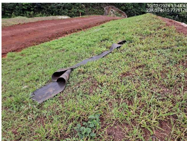
Foto 6.59 – Presença de material solto (geomembrana) na face do talude de jusante.
