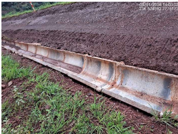
Foto 6.69 – Dispositivo de drenagem superficial da berma elev. 1.119,0 descalçado.
