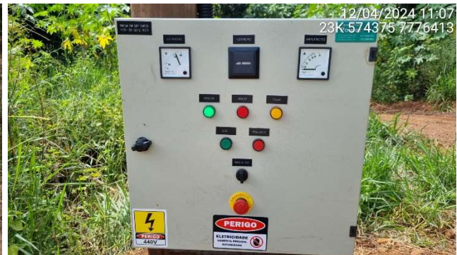
Foto 5.2 – Quadro de comando do poço PT-03.
