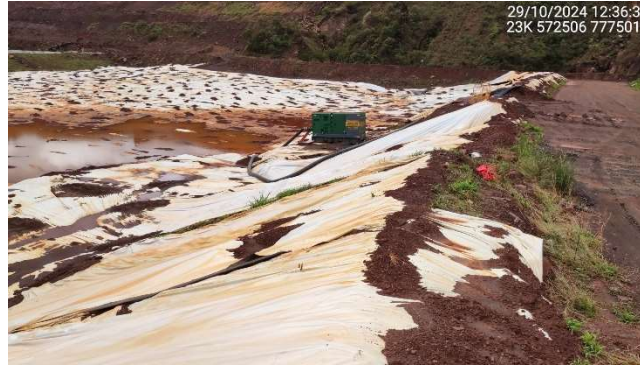
Foto 5.6 – Sistema de bombeamento localizado na baía de jusante.
