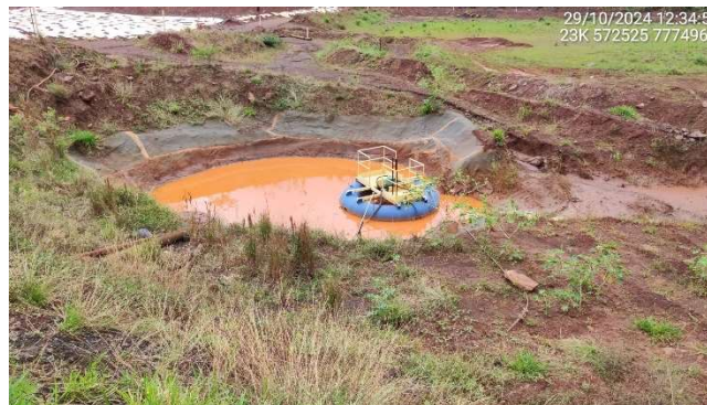
Foto 5.5 – Sistema de bombeamento localizado na baía intermediária.
