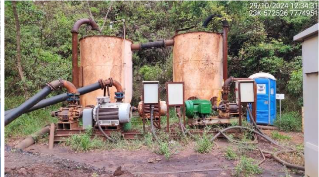
Foto 5.2 – Vista dos tanques e bomba BA13.
