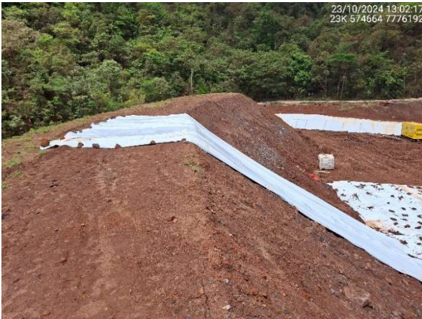
Foto 6.81 – Ancoragem inadequada do PEBD na crista e na face do talude de montante.
