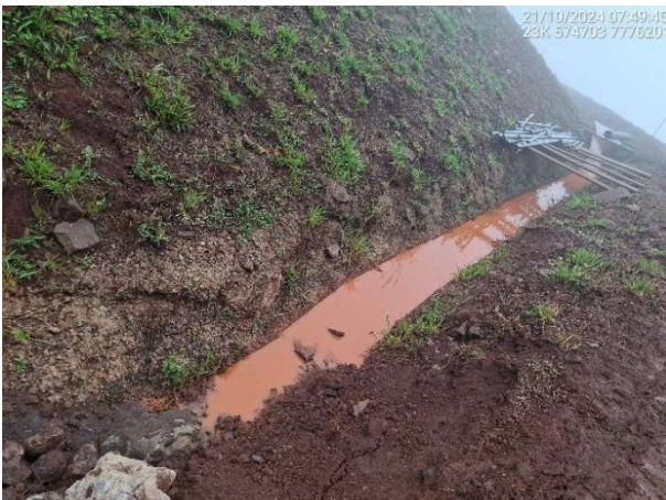
Foto 6.77 – Drenagem superficial da berma El. 1.119,00 obstruída e alagada.
