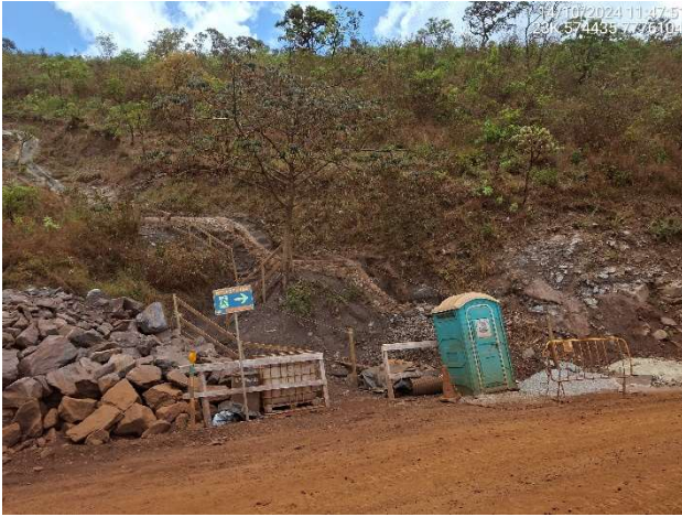
Foto 5.3 – Conclusão da instalação de dispositivos de drenagem superficial no contato da cunha com o terreno natural, na ombreira esquerda.
