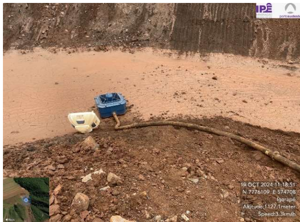
Foto 6.61 – Bomba instalada no sump do reservatório.
