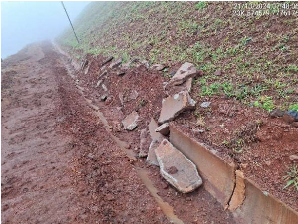
Foto 6.75 – Dispositivo de drenagem superficial danificado, localizado na berma El. 1.119,00 m.
