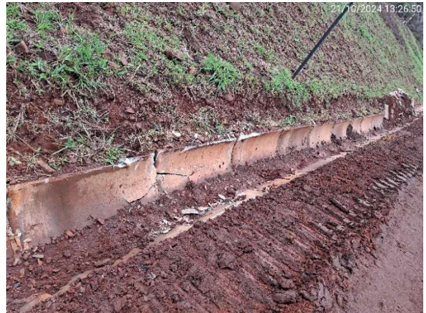
Foto 6.76 – Dispositivo de drenagem superficial, danificado, localizado na berma El. 1.119,00 m.
