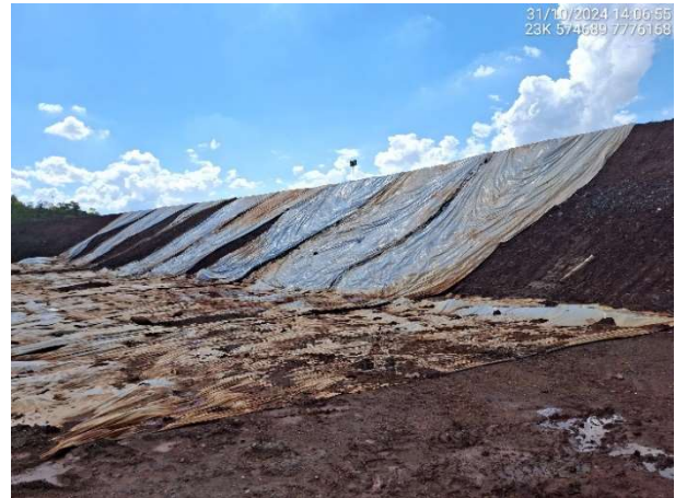
Foto 6.82 – Transpasse inadequado do PEBD na face do talude de montante.
