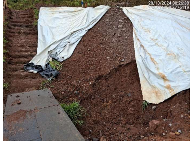
Foto 6.74 – Carreamento de material para dentro do dispositivo de drenagem superficial.
