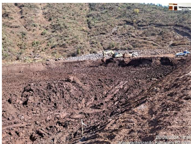
Foto 6.9 – Escavação do rejeito no contato com o talude de montante – Etapa 1 – Fase 1D.
