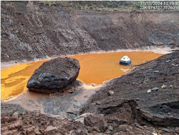
Foto 6.87 – Bomba principal instalada no sump do reservatório.
