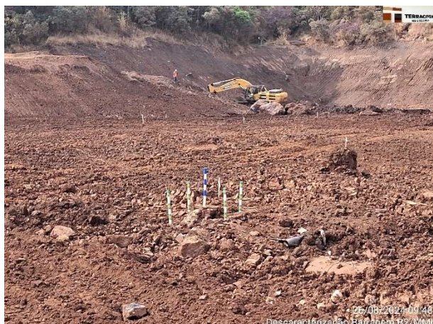
Foto 6.17 – Rebaixamento do instrumento INA-33.
