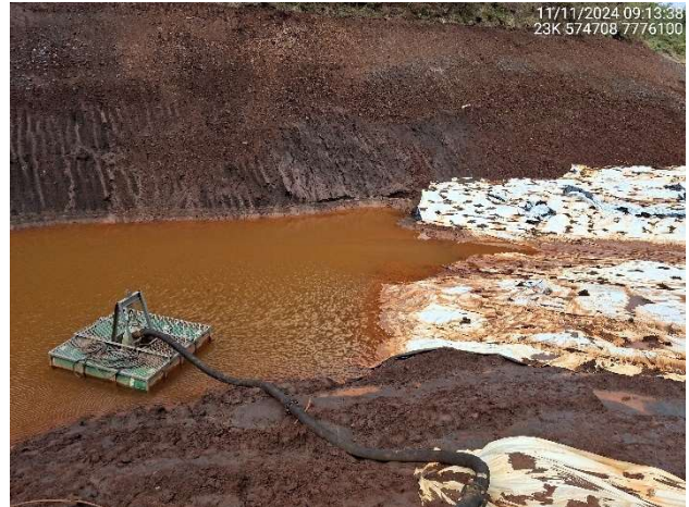
Foto 6.88 – Bomba sobressalente instalada no sump do reservatório.
