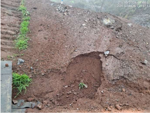
Foto 6.73 – Carreamento de material para dentro do dispositivo de drenagem superficial.
