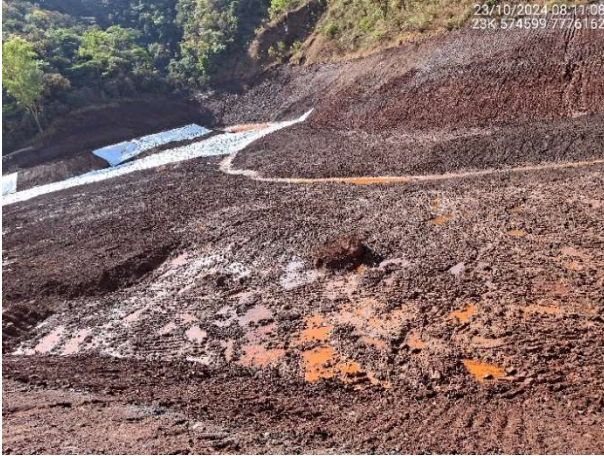
Foto 6.85 – Instrumento INA-33 sem proteção e não identificado no reservatório.
