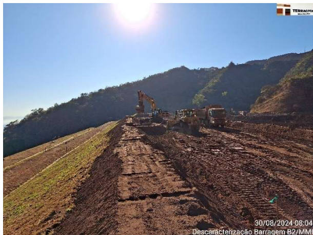
Foto 6.71 – Material oriundo da escavação do maciço e do reservatório contaminando a face do talude de jusante.
