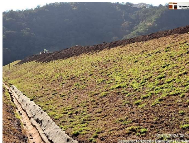
Foto 6.72 – Material oriundo da escavação do maciço e do reservatório contaminando a face do talude de jusante.
