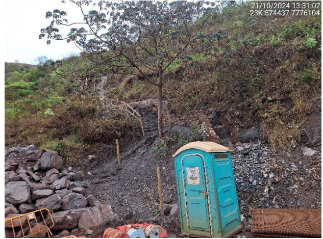
Foto 5.4 – Conclusão da instalação de dispositivos de drenagem superficial no contato da cunha com o terreno natural, na ombreira esquerda.
