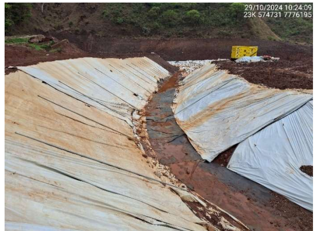
Foto 6.84 – Necessidade de substituição do revestimento dos taludes por manta cimentícia.
