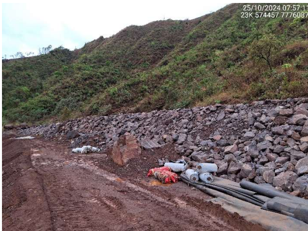
Foto 5.1 – Berma de equilíbrio em enrocamento na encosta próxima a ombreira esquerda.
