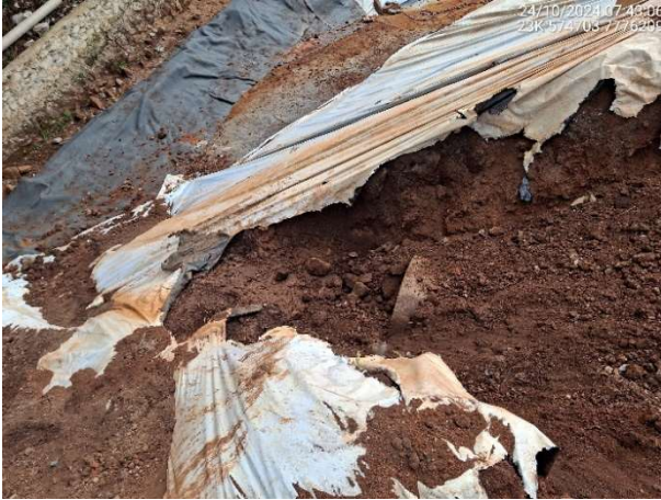
Foto 6.79 – Deságue inadequado da drenagem superficial na face do talude do canal de conexão.
