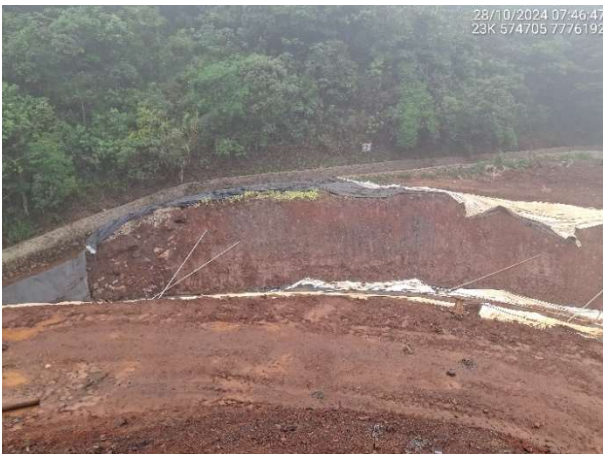
Foto 6.83 – Necessidade de substituição do revestimento dos taludes por manta cimentícia.
