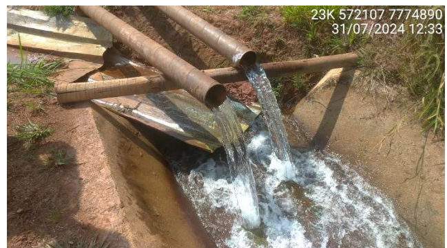
Foto 5.4 – Vista do direcionamento do fluxo dos poços para o extravasor da Barragem B1A Emicon.
