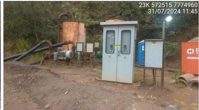
Foto 5.2 – Vista dos tanques e bomba BA13.
