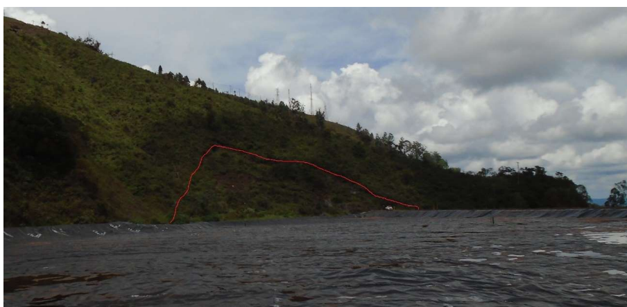
Figura 5.8 – Vista do escorregamento situado na encosta a montante do reservatório.
