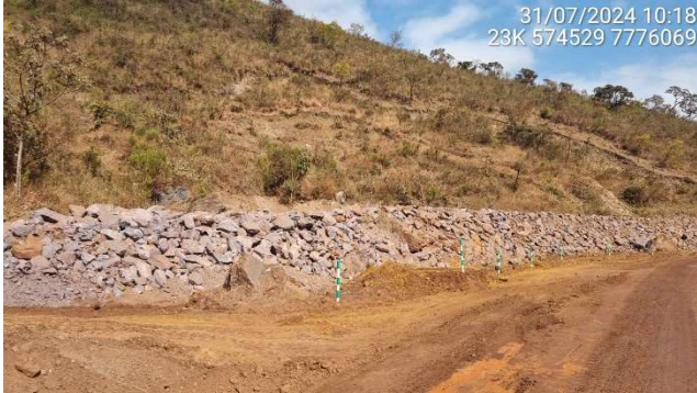
Foto 5.5 – Berma de equilíbrio em enrocamento na encosta próxima a ombreira esquerda.
