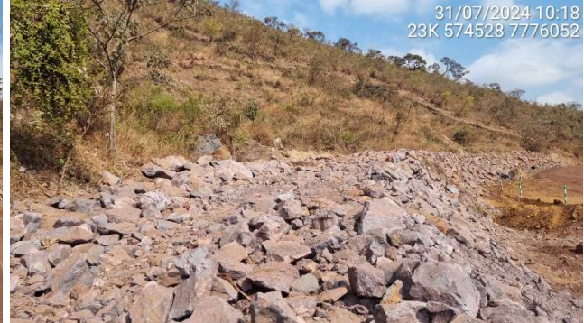
Foto 5.6 – Berma de equilíbrio em enrocamento na encosta próxima a ombreira esquerda.
