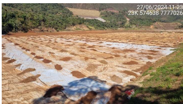
Foto 5.1 – Reservatório parcialmente impermeabilizado.
