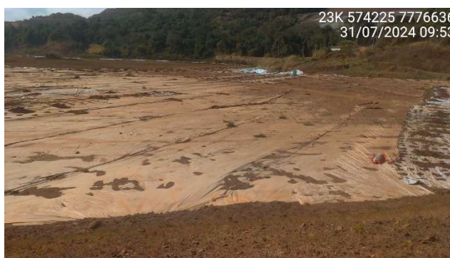
Foto 5.2 – Reservatório parcialmente impermeabilizado.
