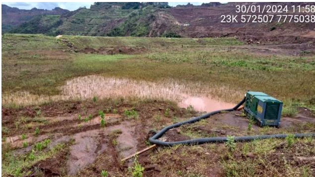
Foto 5.3 – Sistema de bombeamento localizado na baía de jusante.
