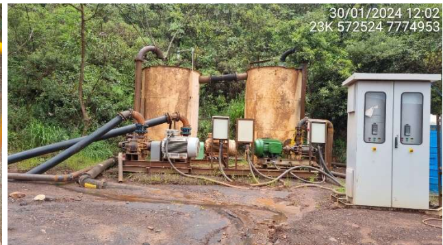
Foto 5.2 – Vista dos tanques e bomba BA13.
