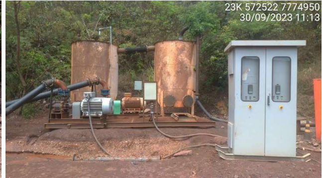
Foto 5.2 – Vista dos tanques e bomba BA13.
