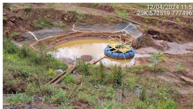
Foto 5.5 – Sistema de bombeamento localizado na baía de montante.
